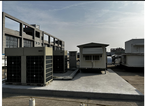
预除湿机（楼顶）
