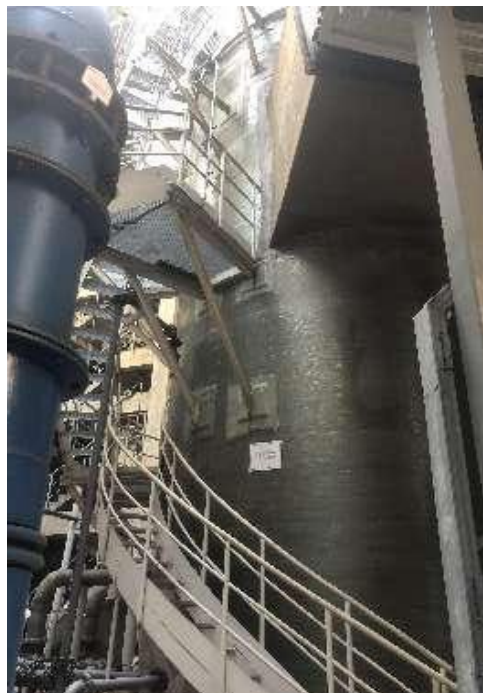
脱硫废水浓缩塔
