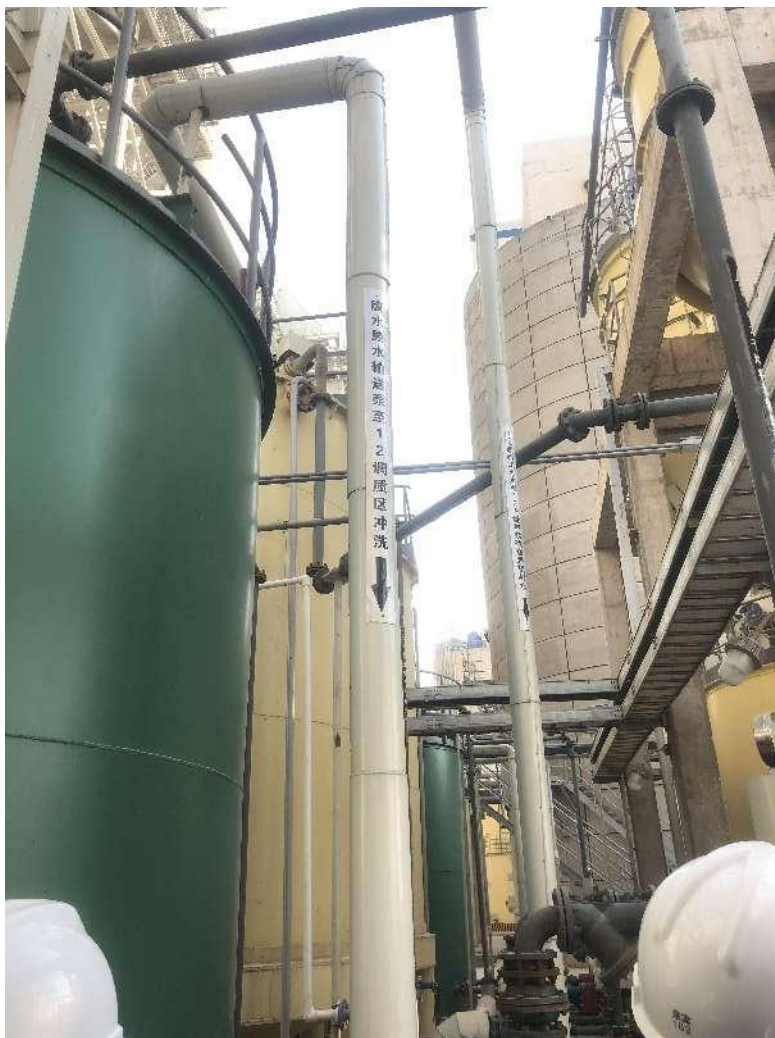
脱硫废水调质冲洗区
