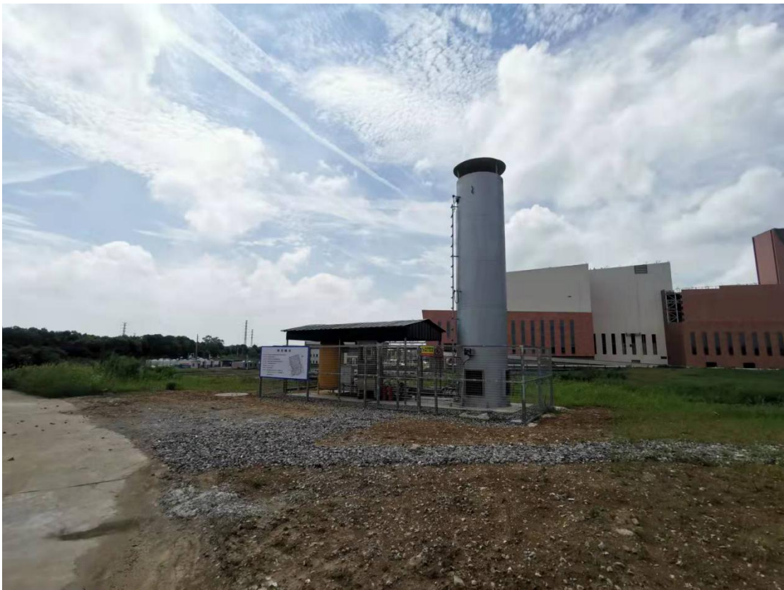
图 2-11 填埋废气燃烧装置
