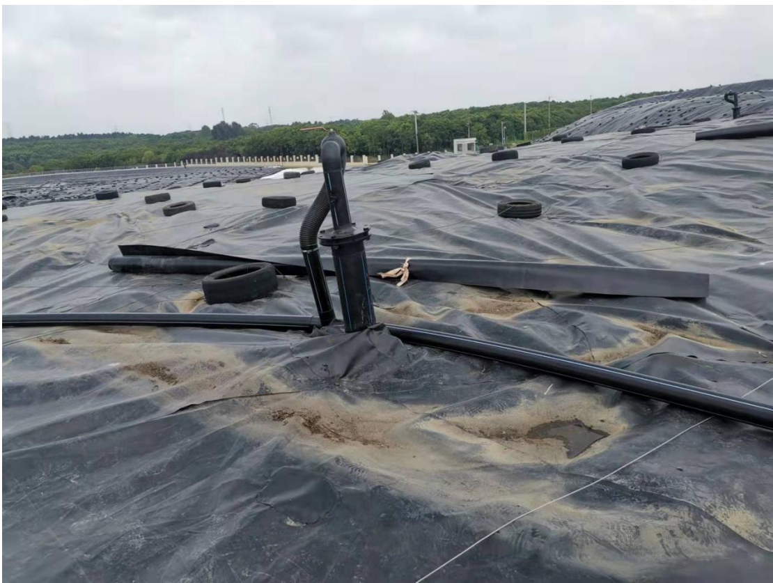
图 2-10 填埋废气收集措施
