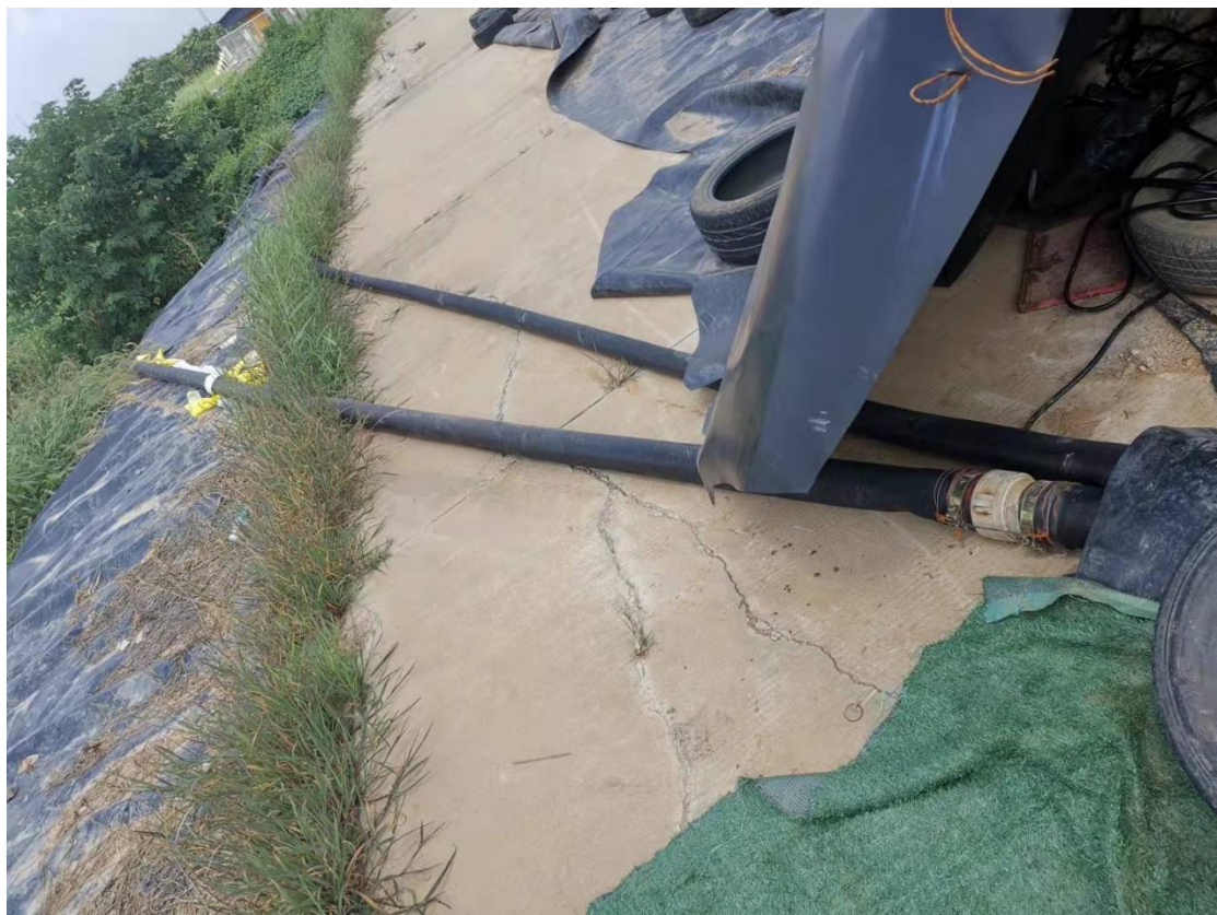
图 2-6 渗滤液运输管道
