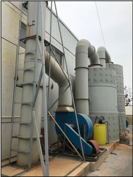
图 4.1-5 项目废气治理设施图
